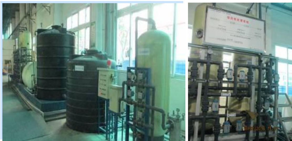
▲ 含鎳廢水回收設備
