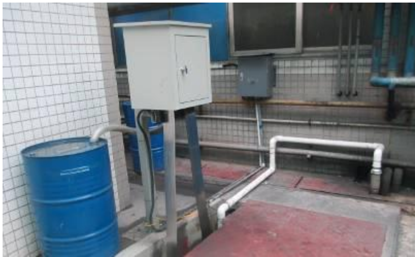
▲ 油水分離設備
