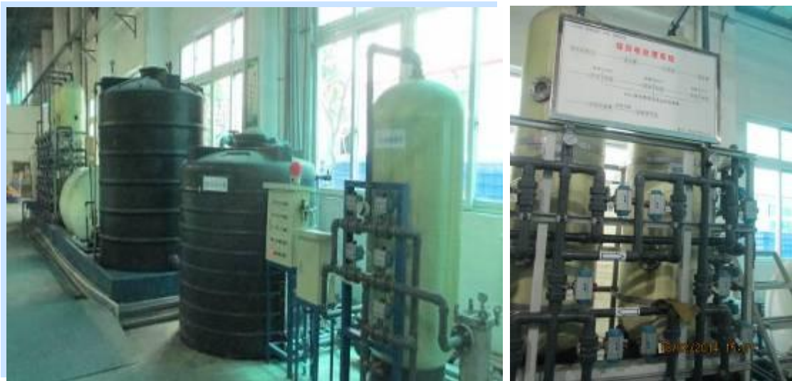
▲ 含鎳廢水回收設備
